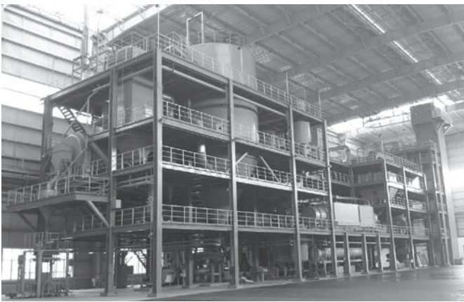
弊社施工大型生産機の一例
